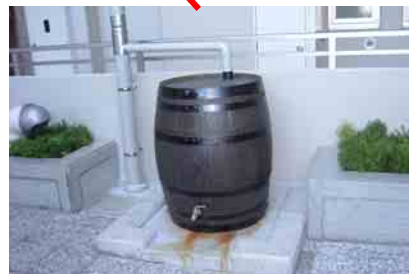
流域分担（雨水貯留タンク）
