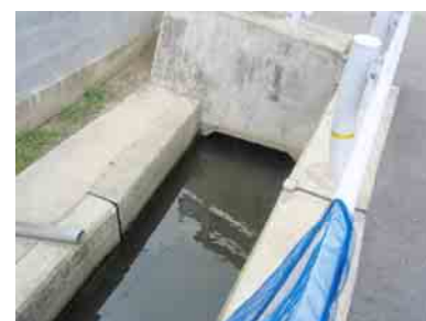
側溝の能力不足箇所
