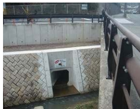
雨水管整備状況
