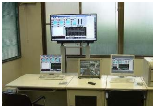
水管理システム中央監視所 （操作台）
