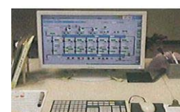
監視制御装置
