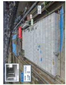
雨水貯留施設（安満遺跡公園）
